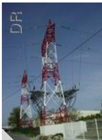
Réseaux haute tension
